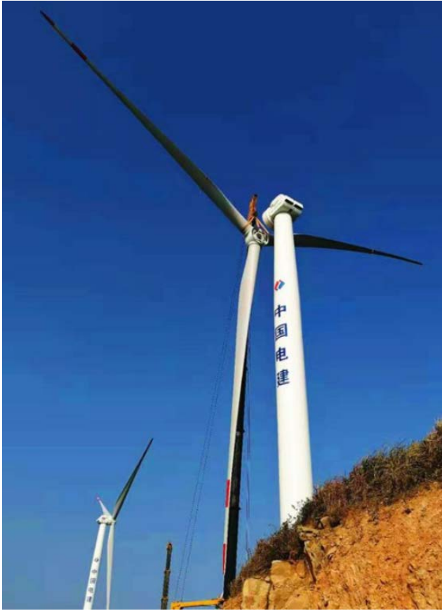
湖南衡东金觉峰风电场项目
