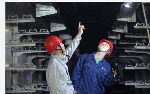
工作人员在芙蓉路电缆隧道进行例行巡视，确保设备正常运行
