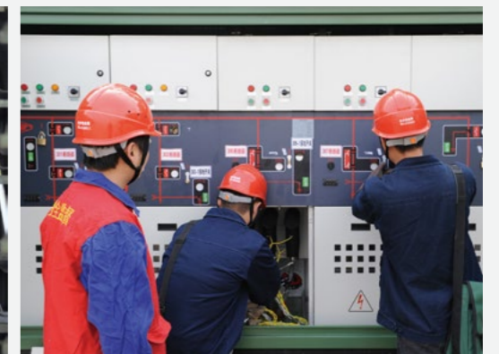
工作人员在对智能配电环网柜进行设备巡检
