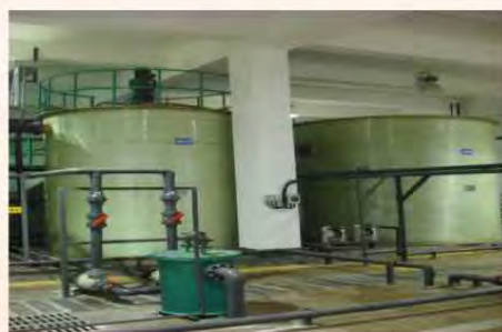
含氟废水处理设施
