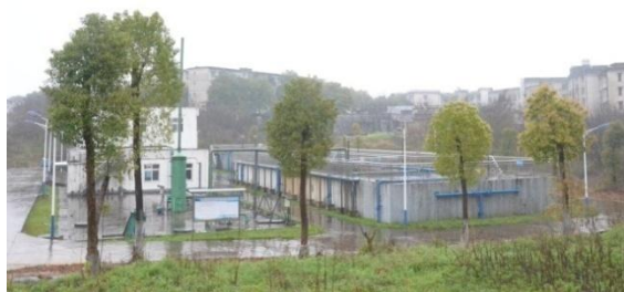
公司污水处理站
