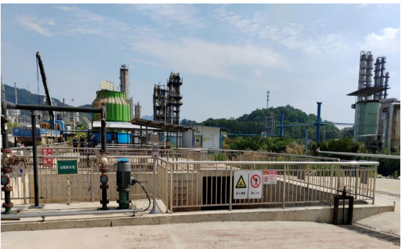
新岭化工雨水收集池
