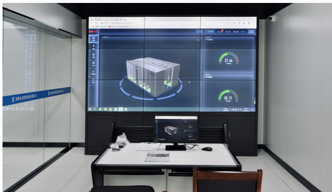
新数据中心机房
