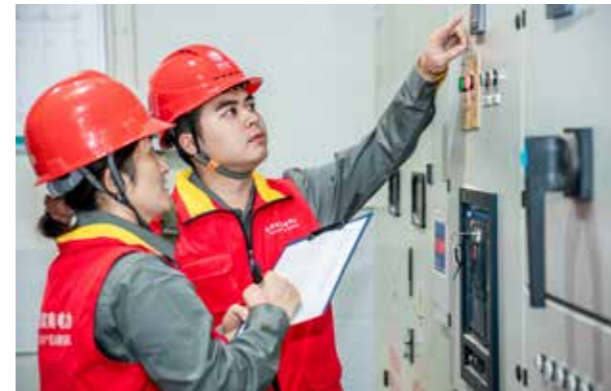
为企业检查用电设备运行情况
