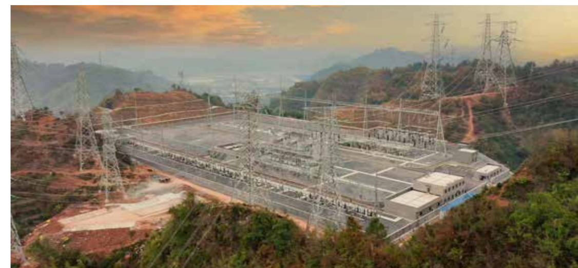
▲ 500千伏湘西边城变电站顺利投产
