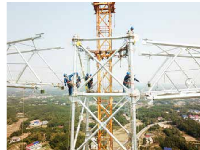
▲ 1000千伏南昌至长沙特高压交流工程
