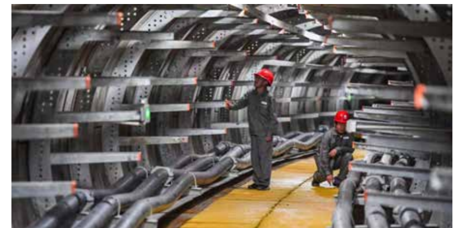
▲ 万家丽路电力隧道
