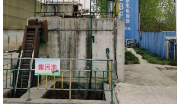
▶ 安欣牧业羊场污水处理厂厌氧反应器
