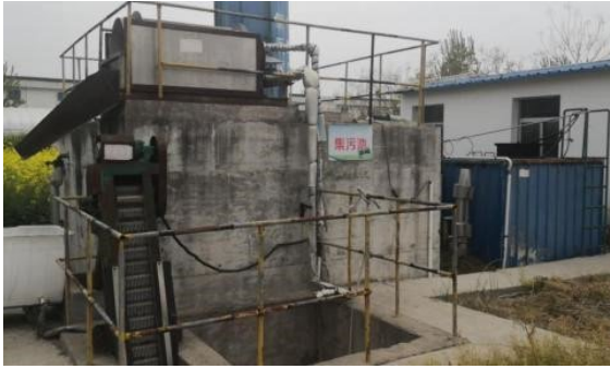
▶ 安欣牧业羊场污水处理厂集污池
