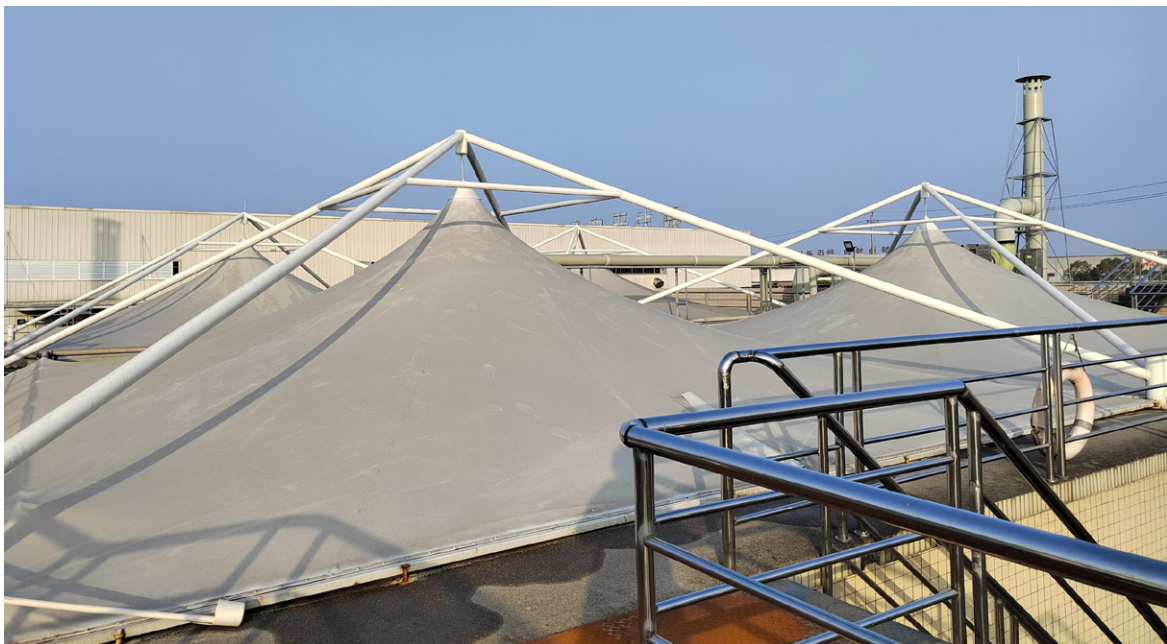
污水处理站—厌氧工艺
