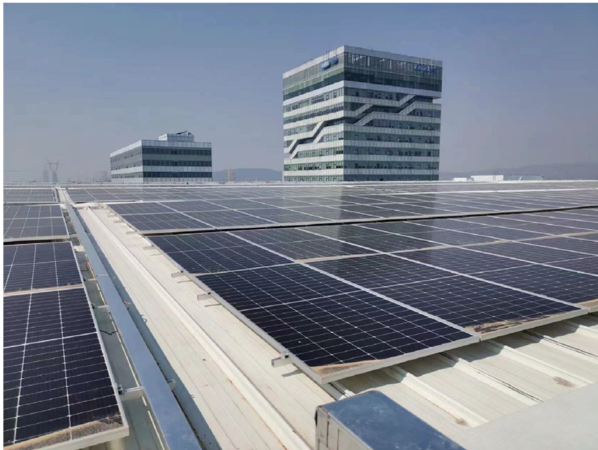
公司总部园区光伏发电屋顶
