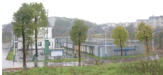
公司污水处理站
