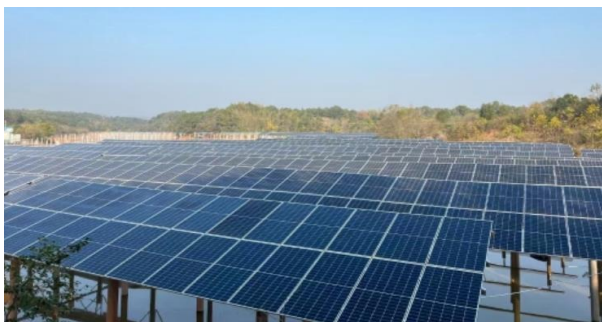
株洲鸭塘复合光伏工程
