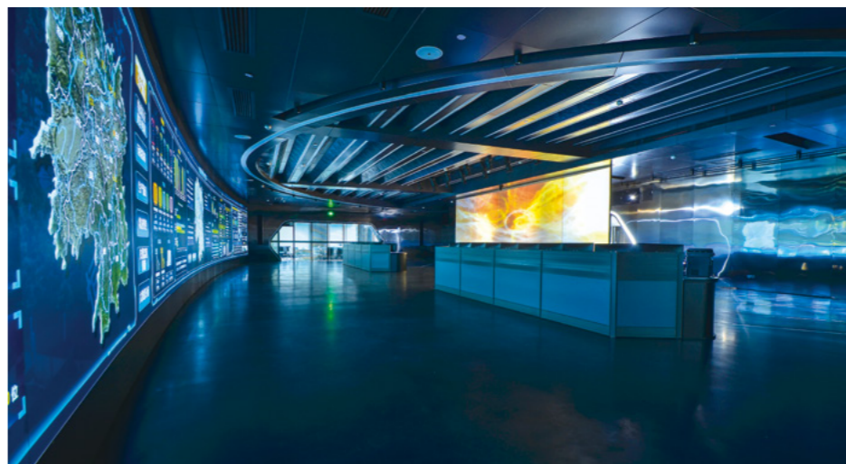
全省配电运行数据集中监控
