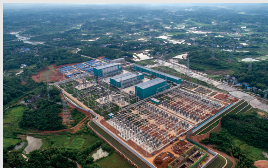
祁韶特高压直流输电工程湘潭换流站
