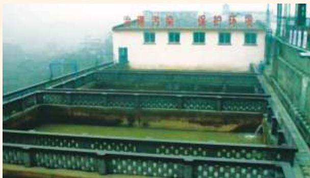
废水处理设施
